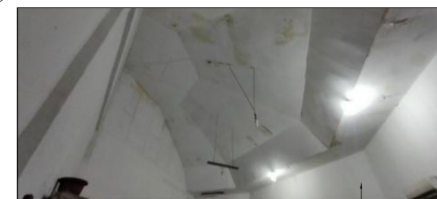
Foto Dokumentasi : Kondisi Plafond Gedung Perpustakaan
