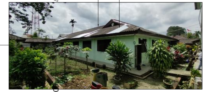
Foto Dokumentasi : Kondisi Atap Ruang Kelas + Koperasi Eksisting
