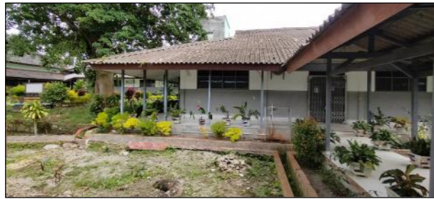
Foto Dokumentasi : Kondisi Atap Ruang Kelas Eksisting
