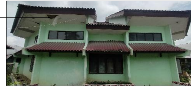
Foto Dokumentasi : Kondisi Plafond Gimal Belakang Gedung Perpustakaan
