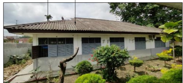
Foto Dokumentasi : Kondisi Atap Ruang Kelas Eksisting
