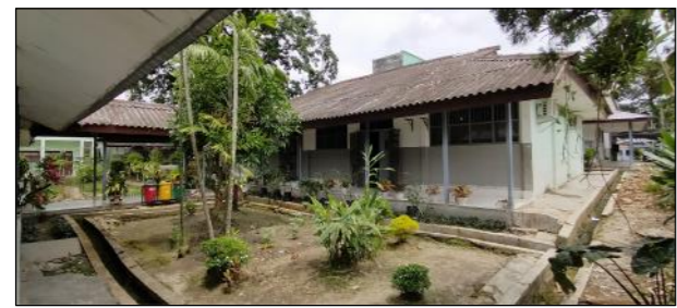
Foto Dokumentasi : Kondisi Atap Ruang Kelas Eksisting
