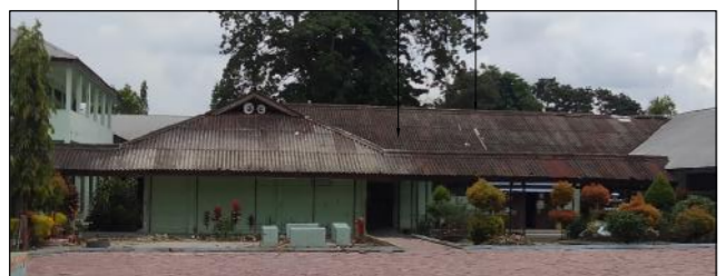
Foto Dokumentasi : Kondisi Atap Ruang Kelas + Koperasi Eksisting
