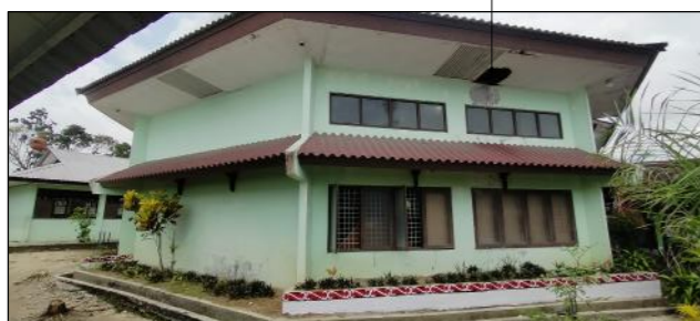
Foto Dokumentasi : Kondisi Plafond Gimal Samping Gedung Perpustakaan
