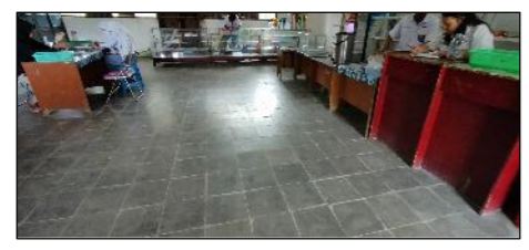
Foto Dokumentasi : Kondisi Lantai Ruang OTKP
